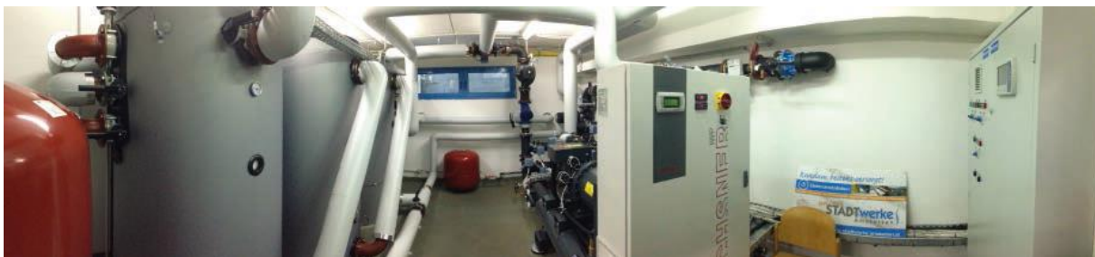
Abbildung 17: Die OCHSNER Wärmepumpe IWWS210ER2 (hier im Bild samt den in Serie geschalteten Pufferspeichern) kann dank der hohen Abwassertemperaturen von ca. 22°C äußerst effizient arbeiten.
