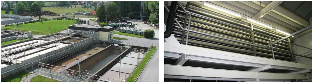
Abbildung 15 links: In Weiz wird nach der Kläranlage Wärme gewonnen und damit zwei gewerbliche Betriebe beheizt. Mit der Anlage kann auch gekühlt werden. Rechts: Einer der beiden Abwasserwärmetauscher; Quelle: Grazer Energieagentur
