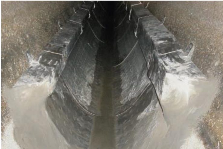
Abbildung 18: Der Abwasserwärmetauscher „Thermliner“ der Anlage STADTwerke Amstetten (hier kurz nach Montage im Abwasserkanal) wurde in Absprache mit der Stadtentwässerung geplant und gebaut und erlaubt weiterhin einen störungsfreien Betrieb der Kanalisation.
