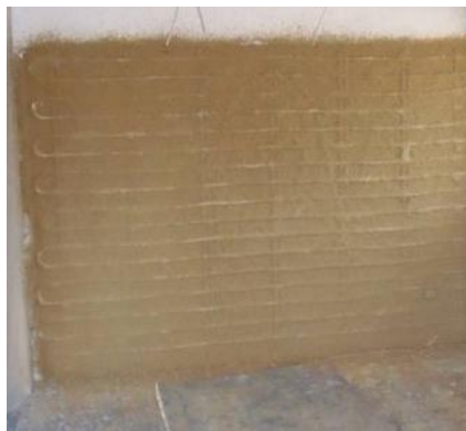
Abbildung 43: Wandheizung mit einer Lage Lehmputz
