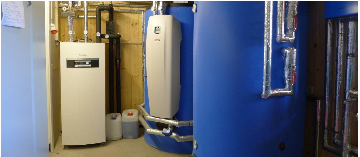
Abbildung 41: Heizraum mit Wärmepumpe und zwei Pufferspeichern
