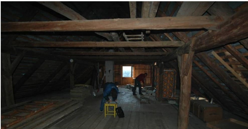
Abbildung 38: Der bestehende Dachstuhl entsprach weder den statischen Bedingungen, noch war er geeignet, zu einem Passivhausstandard hochgerüstet zu werden.
