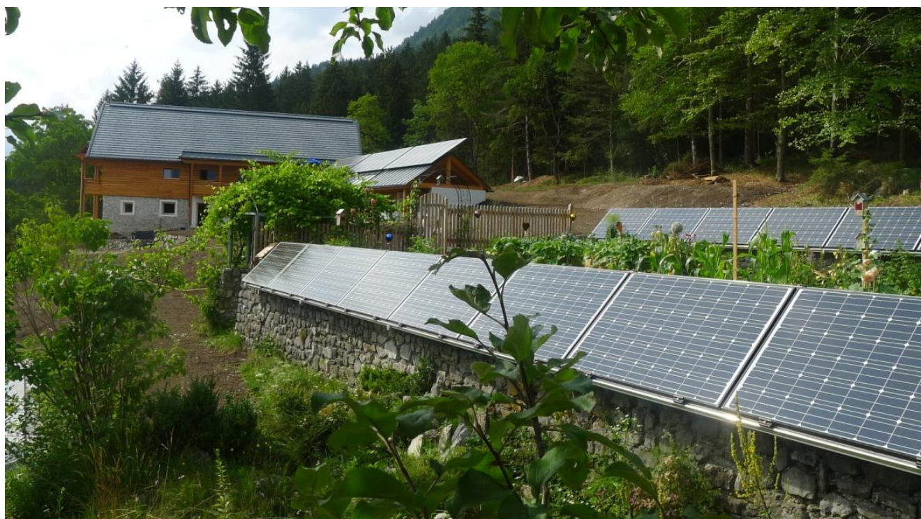
Abbildung 65: Anlage 1 im Hintergrund, Anlage 3 im Vordergrund
