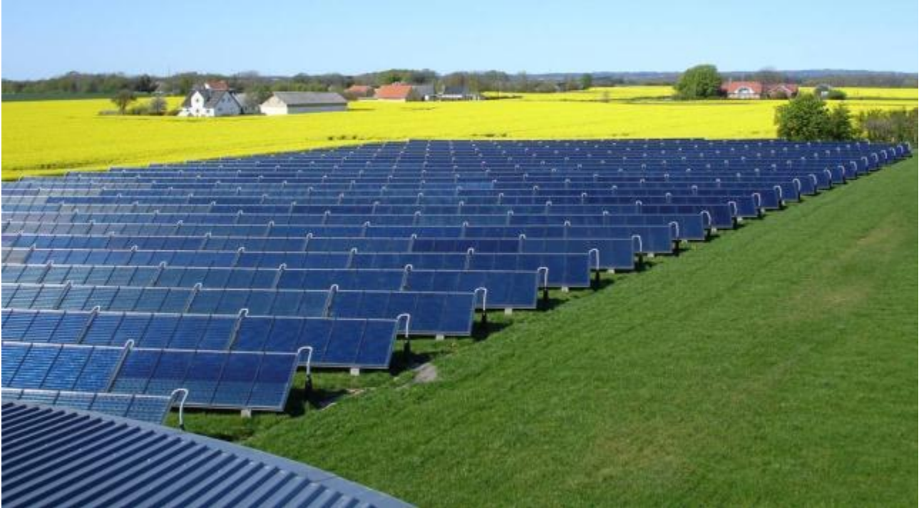
Abbildung 3-3. Solare Großanlage mit 5,012 m 2 Kollektorfläche in Dänemark, Ulsted (Bildquelle: ARCON A/S)
