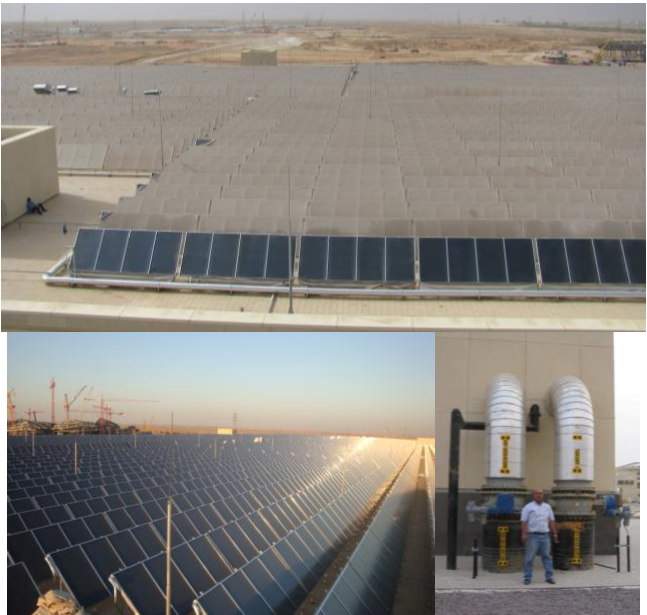
Abbildung 3-4. Solare Großanlage zur Versorgung eines Universitätscampus in Riad, Saudi Arabien (Bild oben: Inbetriebnahme – Kollektoren sind abgedeckt, damit das System nicht überhitzt; Bild unten links: Kollektorfeld fertiggestellt, in Betrieb; Bild unten rechts: Fernwärme VL und RL Leitungen (Bildquelle: AEE INTEC)
