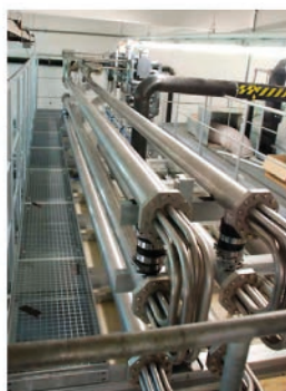
Abb. 13: Selbstreinigender Wärmetauscher. Jaske & Wolf Verfahrenstechnik GmbH.
