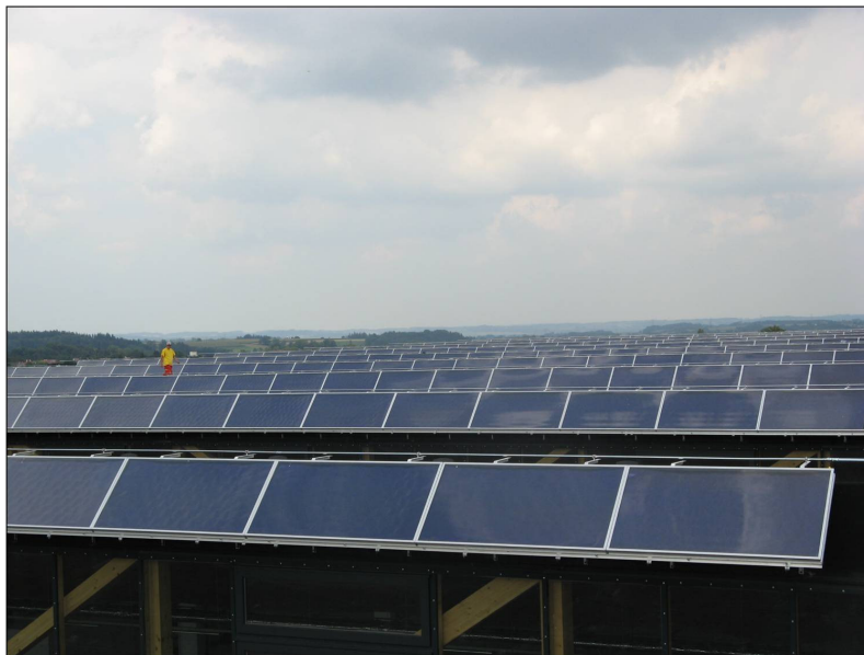
Bild 2: Sheddach mit Verschattung durch thermische Solarkollektoren
