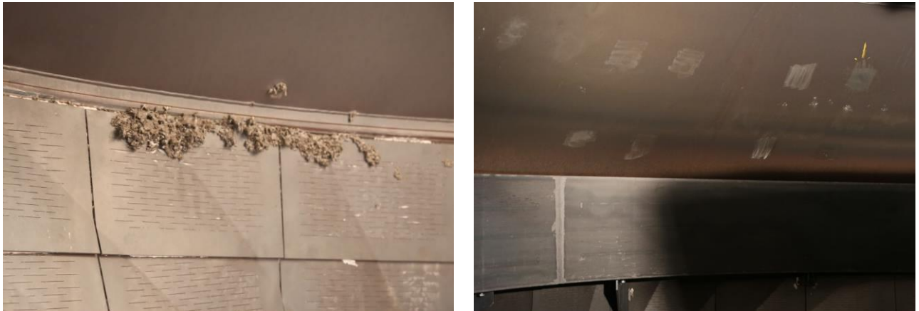
Abbildung 20: Links: Der Bereich unterhalb des Wassermantels ist äußerst sensibel bzgl. Schlackenanhaftungen. Rechts: Der neu installierte Wasserring verhindert das Anhaften von Schlackepartikel und lässt diese in das Wirbelbett fallen um dort abgekühlt zu werden
