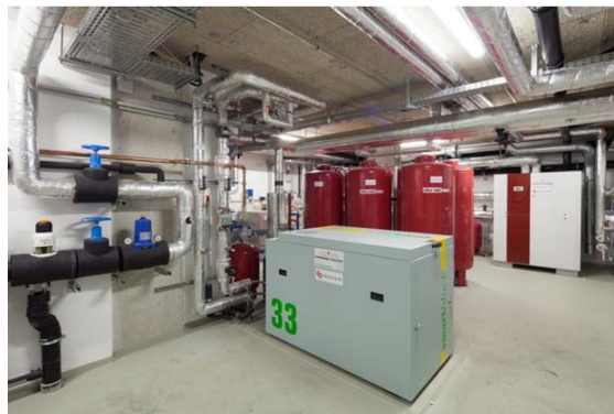
Abbildung 2: Energiezentrale mit BHKW biogasbetrieben, Wärmepumpe und Fernwärme als Backup (Foto: © DI Christof Reich)
