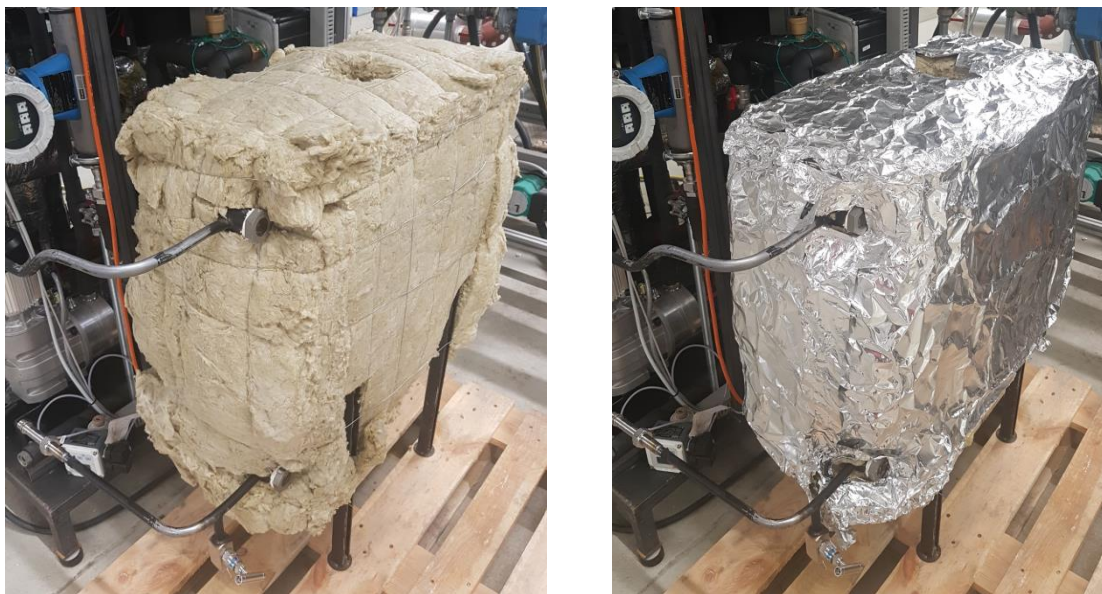
Abbildung 16: Kältemittelgekühlter Abgaswärmeübertrager (Dämmung)
