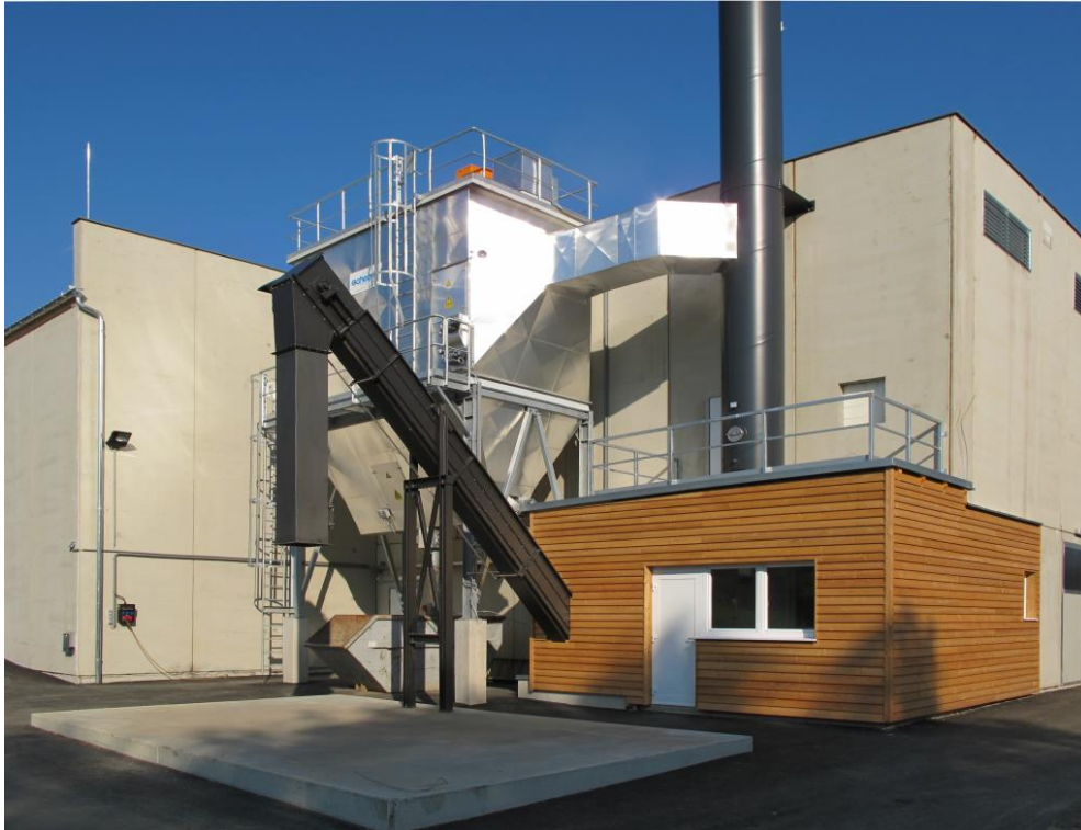
Bild 2 Heizwerk Stainz (Quelle: nahwaerme.st GmbH)
