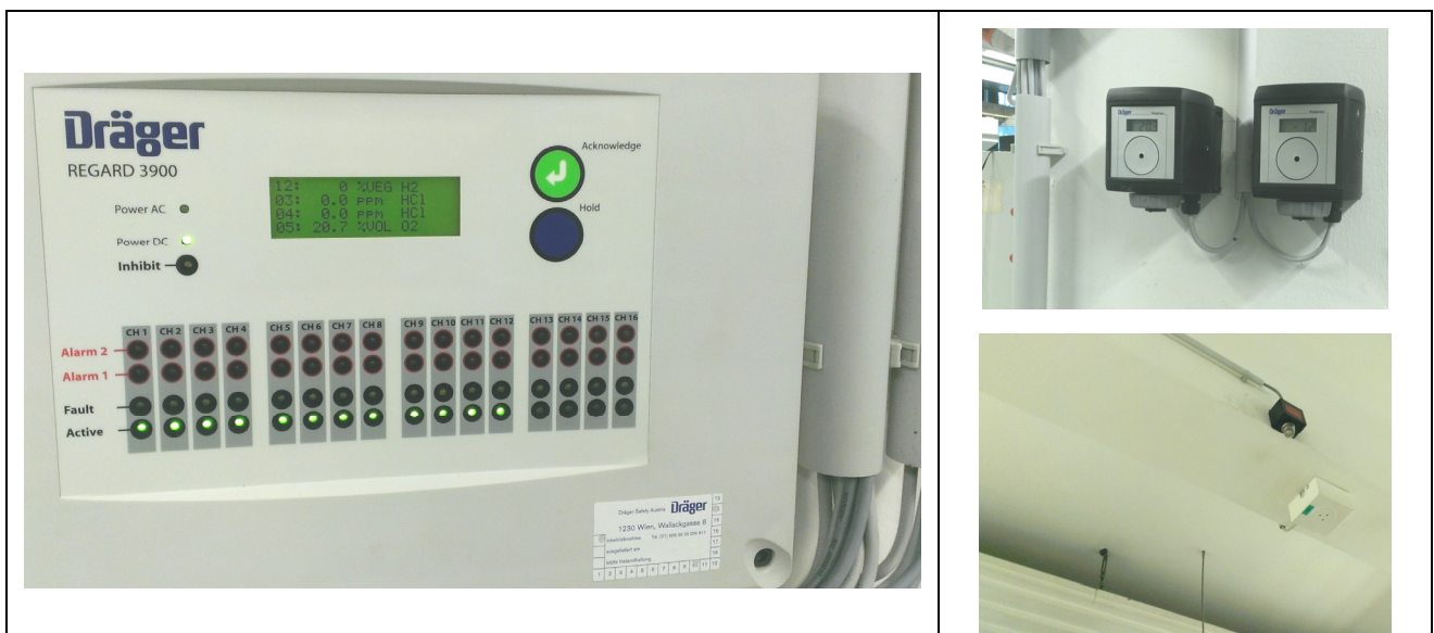
Abbildung 16: Fix installiertes Gaswarnsystem
